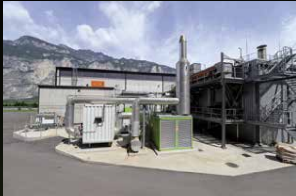
Impianto di cogenerazione del biogas in energia elettrica
