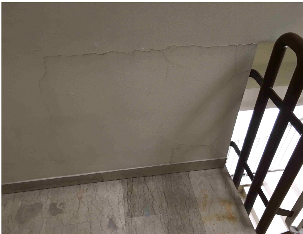
Foto 4: fessurazione tra parete di tamponamento e solaio sottotetto sul pianerottolo piano attico
