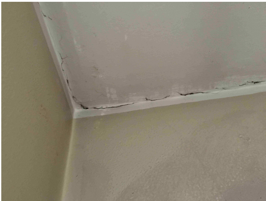
Foto 3: fessurazione tra solaio e tramezza interna nel vano scale al piano attico
